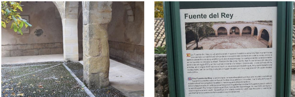
Figura 15. Columnas del lavadero porticado en Fuente del Rey (siglo XVIII) cuyas columnas están restauradas con las calcarenitas de la cantera de Alcalá la Real.
